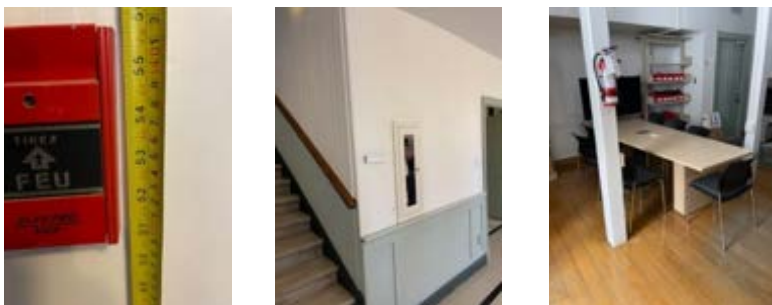
Figure 30. Images des équipements d'incendie
